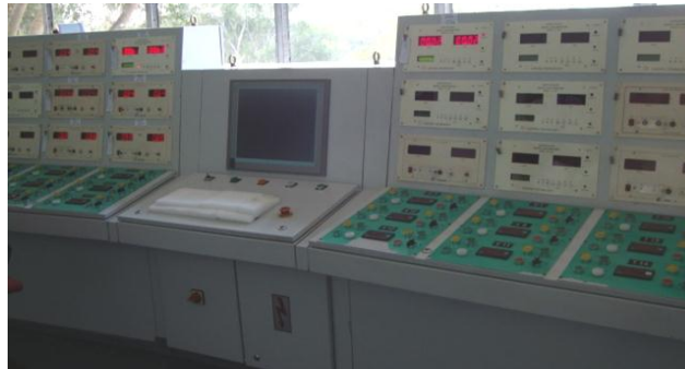
(d) Photograph showing the control panel
