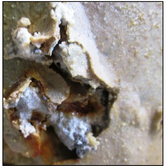
(d) Image showing deteriorated steel slag aggregate
